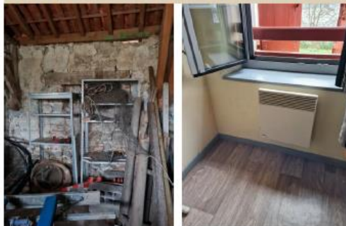
Bâtiment stockage et radiateurs 3 gîtes : des dégradations avancées des maçonneries, notamment des fissures et affaissement sur le mur ouest de cette dépendance. Les radiateurs « grille pain » très consommateurs énergétiques seront à remplacer.
