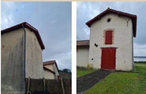
Ensemble des façades : des fissures, champignons, enduits dégradés, sont présents dans l'ensemble des 3 gîtes.
